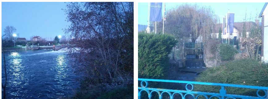
Exemples d'obstacles à l'écoulement – Source : © Ecovia
