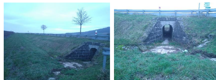
Passage à faune sur le secteur au niveau de la RD933 – Source : © Ecovia
